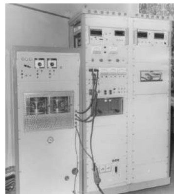
Stanowisko do pomiaru czasu wyłączenia tyrystorów. Od prawej: urządzenie pomiarowe MCD8 i termiczne urządzenie zaciskowe TM8.
